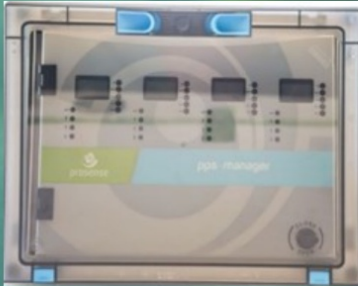
Gaz Kontrol Paneli
