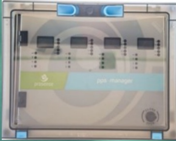
Gaz Kontrol Paneli
